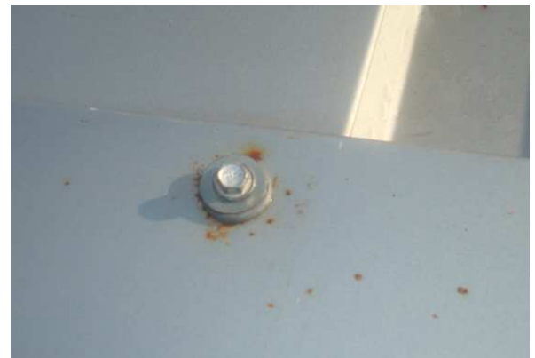
Rostflecken von Bohrspänen
